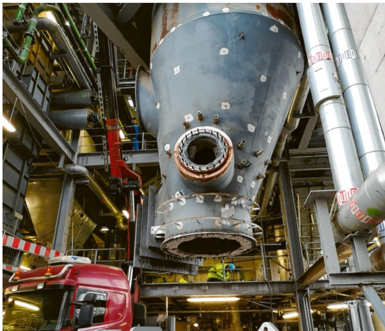
35 Millionen Euro steckten die Stadtwerke Ulm/Neu-Ulm (SWU) 2009 bis 2013 in das Sendener „Holzkraftwerk“. Das Herzstück, der 24 Meter hohe Vergaser wurde nun abmontiert und wird verschrottet. Fotos: Oliver Helmstädter
